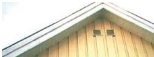
Bild 4. Ett par gavelventiler räcker
